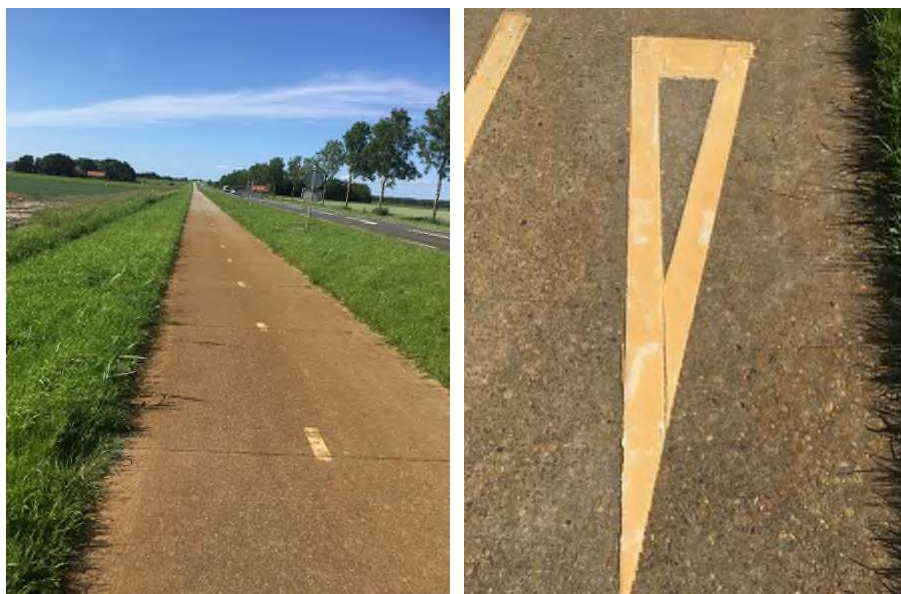
Roodkleuring fietspad door beregening van naastliggend perceel met ijzerhoudend grondwater
